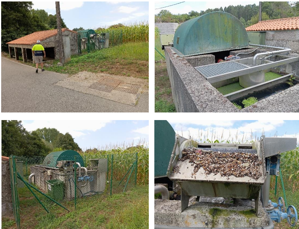
Ilustración 19. Fotografías da EDAR DE RIALDONIO/CAVADA
