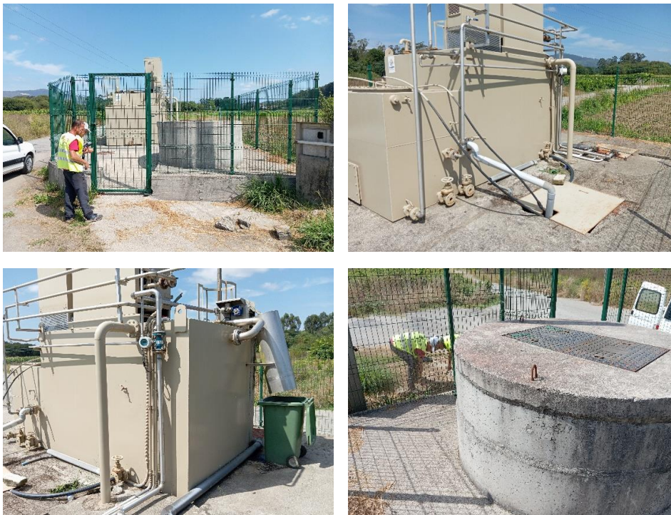
Ilustración 21. Fotografías da EDAR DE LANTAÑÓN
