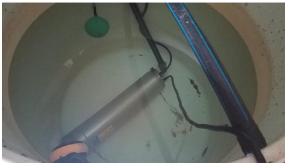
Ilustración 16. Pozo bombeo San Martiño
